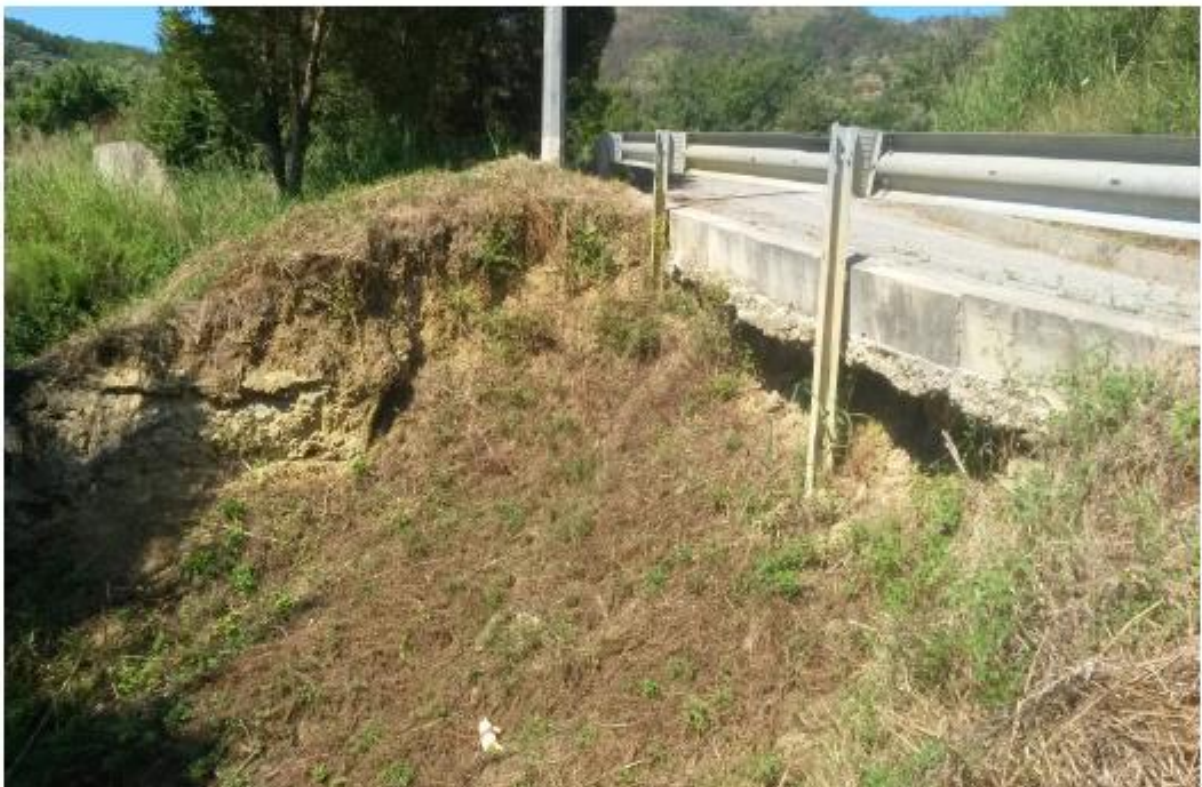
Vista della sponda sottostrada erosa in corrispondenza del vallone Rungi
