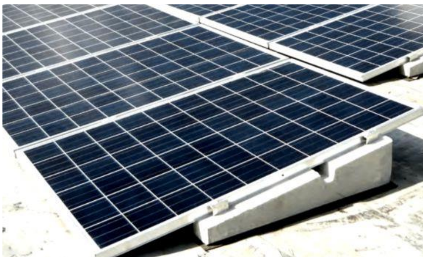
Figura 4 – Esempio di posa dei pannelli su strutture di sostegno a zavorra in calcestruzzo armato
