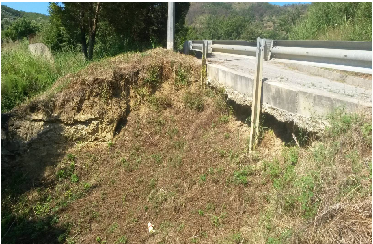
Vista della sponda sottostrada erosa in corrispondenza del vallone Rungj
